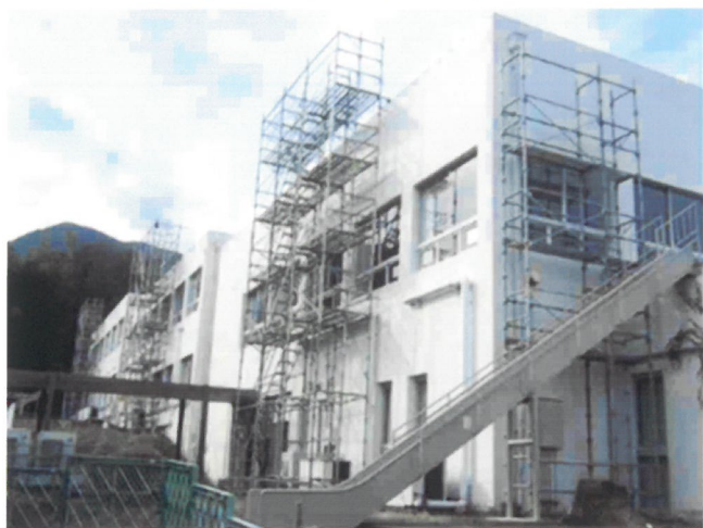
緊急脱出用のスロープが設置されました
