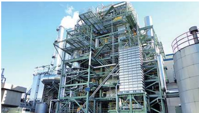
ボイラー外観(大きいものでは高さ70メートルにもなります)
