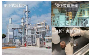
地下式焼却炉
