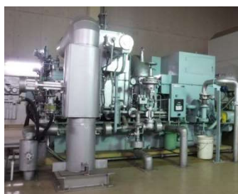
廃棄物発電 (清掃センター)
