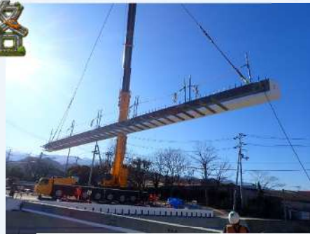
橋梁の新設・架替です。基礎や橋台・橋脚、橋桁の設計・工事監督をします。
