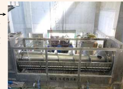
下水処理場 → 家庭や事業所から出る汚水を適切に処理し、きれいな水として自然に戻すための施設です。設備を良好な状態で長く使用するため、汚泥脱水機のオーバーホールを行っています。
