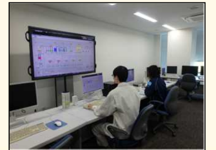
← 新居浜市庁舎 中央監視装置 新居浜市庁舎の電気系統を一括して制御できるシステムです。建物で電気を安全に使うために、電路や使用機器、設置場所を考えます。
