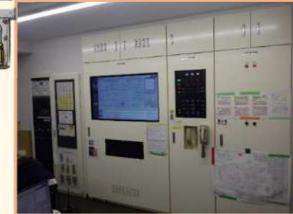
水道施設集中監視装置 → 市内全域に点在する水道施設を一括監視できるシステムです。施設の維持管理、改修を行っています。
