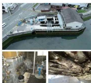
既存施設の老朽化状況
