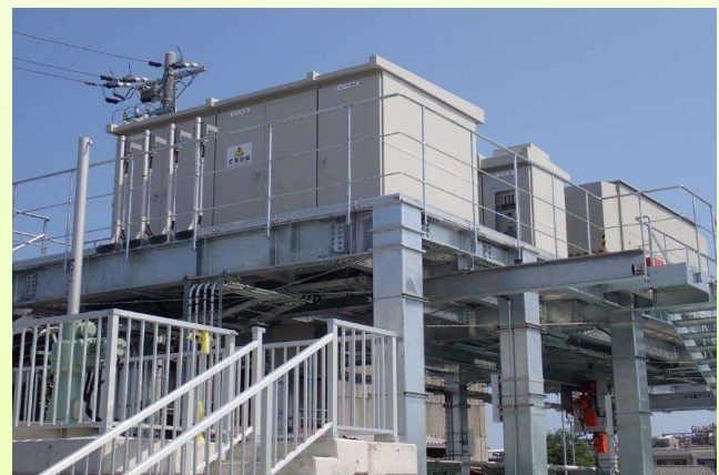
電気計装設備、非常用発電機等
