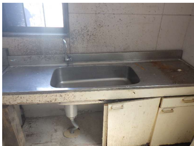
シンク 2 (一部破損)
